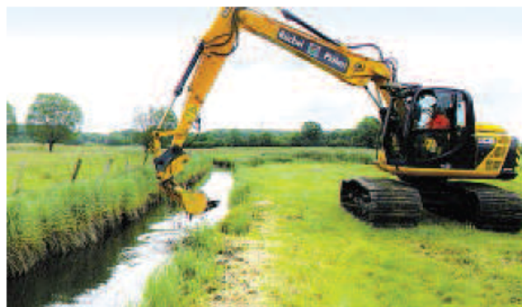
Der Bagger mit Mähkorb wird an der Stente schonend eingesetzt. Fotos: Dr. Mareike Stanisak
